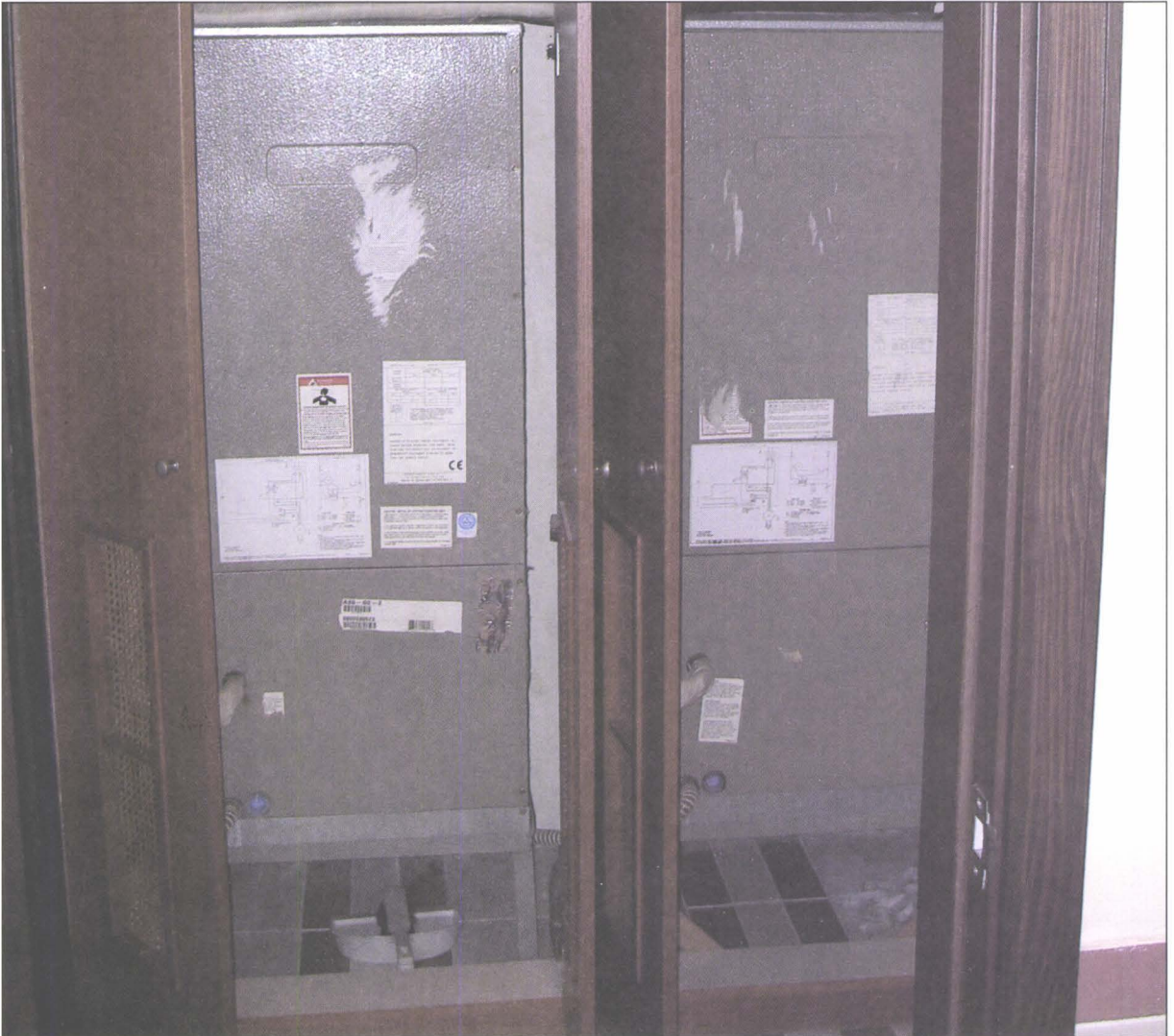
Şekil 5.35. Trio Konutları HAVA KANALLI SPLİT KLİMA İÇ ÜNİTE YERLEŞİMİ (DOLAP İÇİ UYGULAMA)
