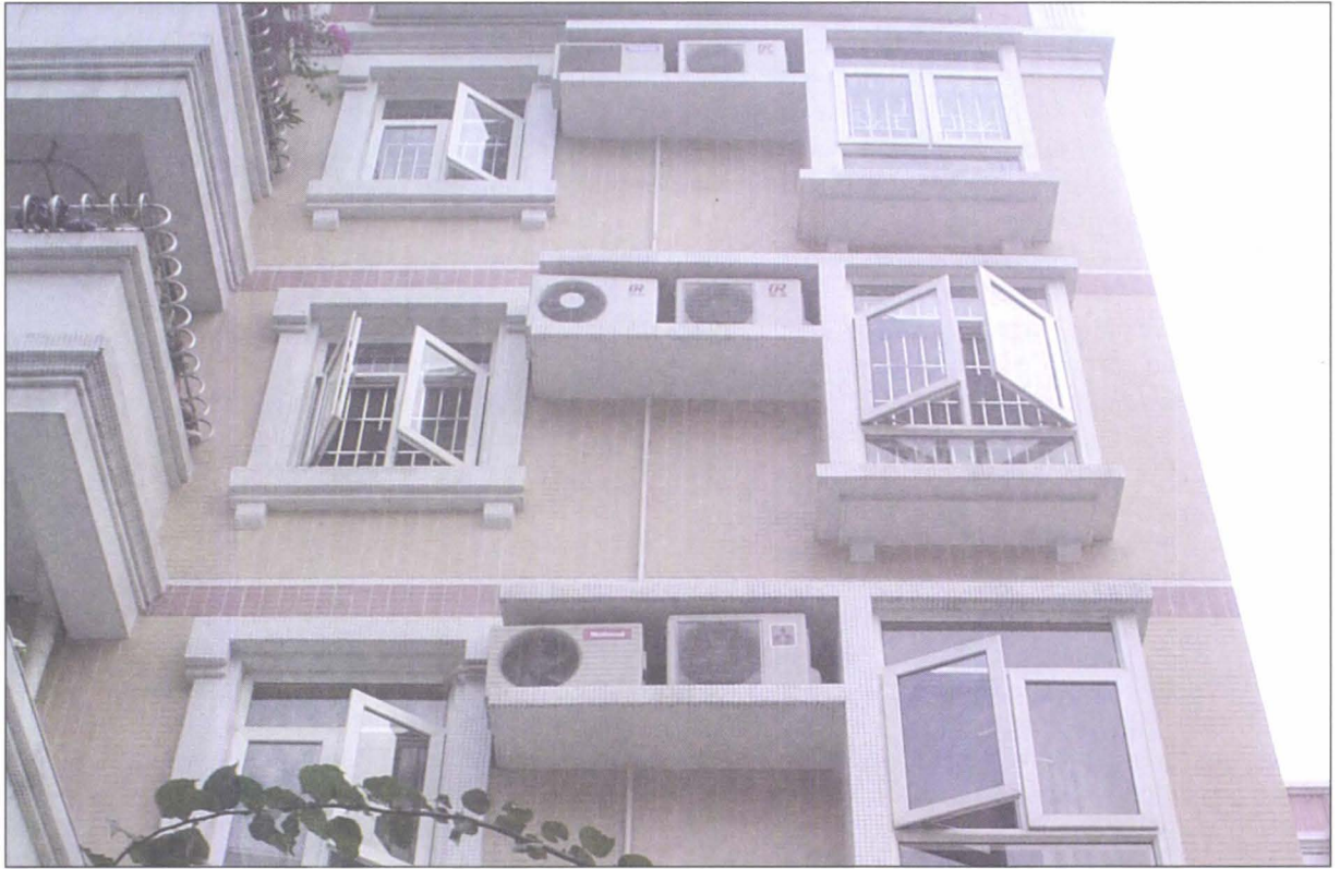
Şekil 5.2. MİNİ SPLIT DIŞ ÜNİTE YERLEŞİMİ DÜZENLİ VE ESTETİK YERLEŞİM YAPILMIŞ, AMA SERVİS VERMEK ZOR. (SERVİS TEKNİSYENİ İÇİN ÇOK RİSKLİ. DIŞ ÜNİTELER ARASINDA DA YETERLİ SERVİS AÇIKLIĞI YOK)
