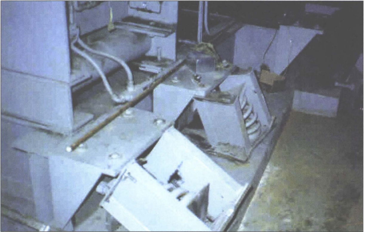
Şekil 13.8. SİSMİK İZOLATÖRLERİ YANLIŞ SEÇİLMİŞ VE YANLIŞ MONTE EDİLMİŞ (KAİDEYE BAĞLANMAMIŞ) BİR SOĞUTMA GRUBUNDA DEPREM SONRASI MEYDANA GELEN HASAR
