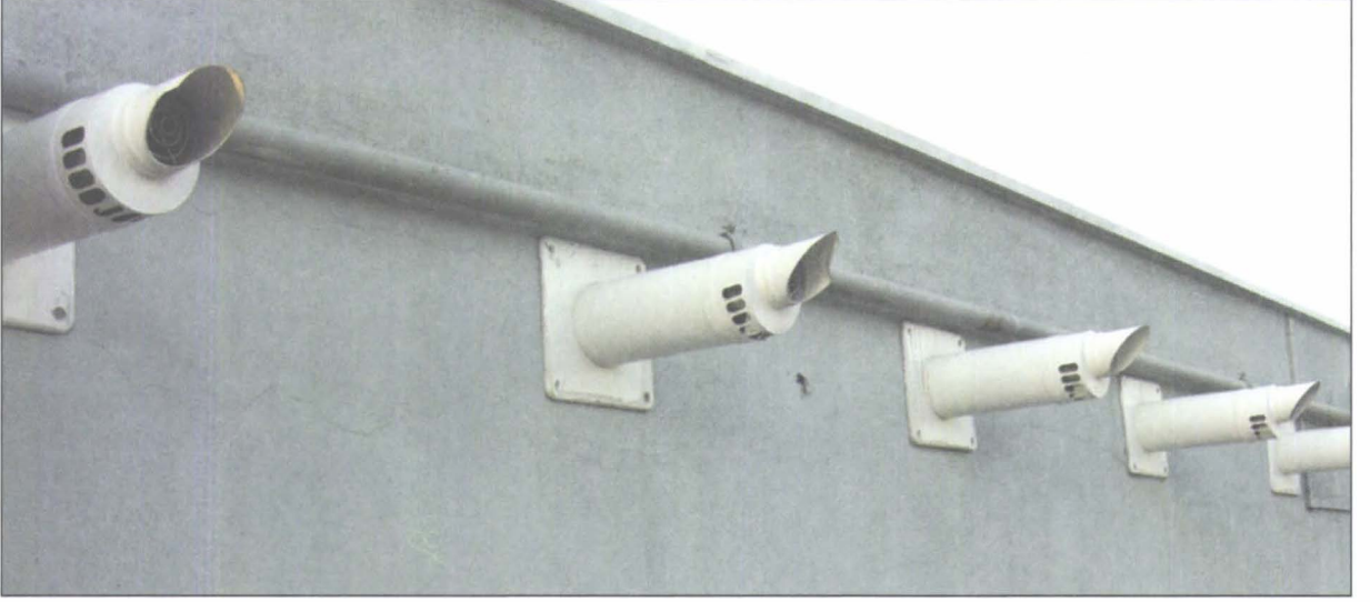
Şekil 5.26. Yüceler Mağazası YOĞUŞMALI KASKAD BACA ÇIKIŞI
