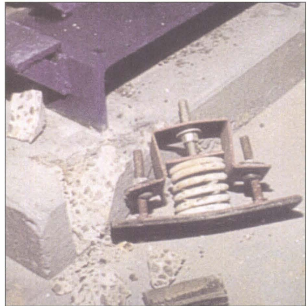
Şekil 13.11. SİSMİK İZOLATÖR İLE KAİDE ARASI BAĞLANTIDAN KAYNAKLANAN HASAR
