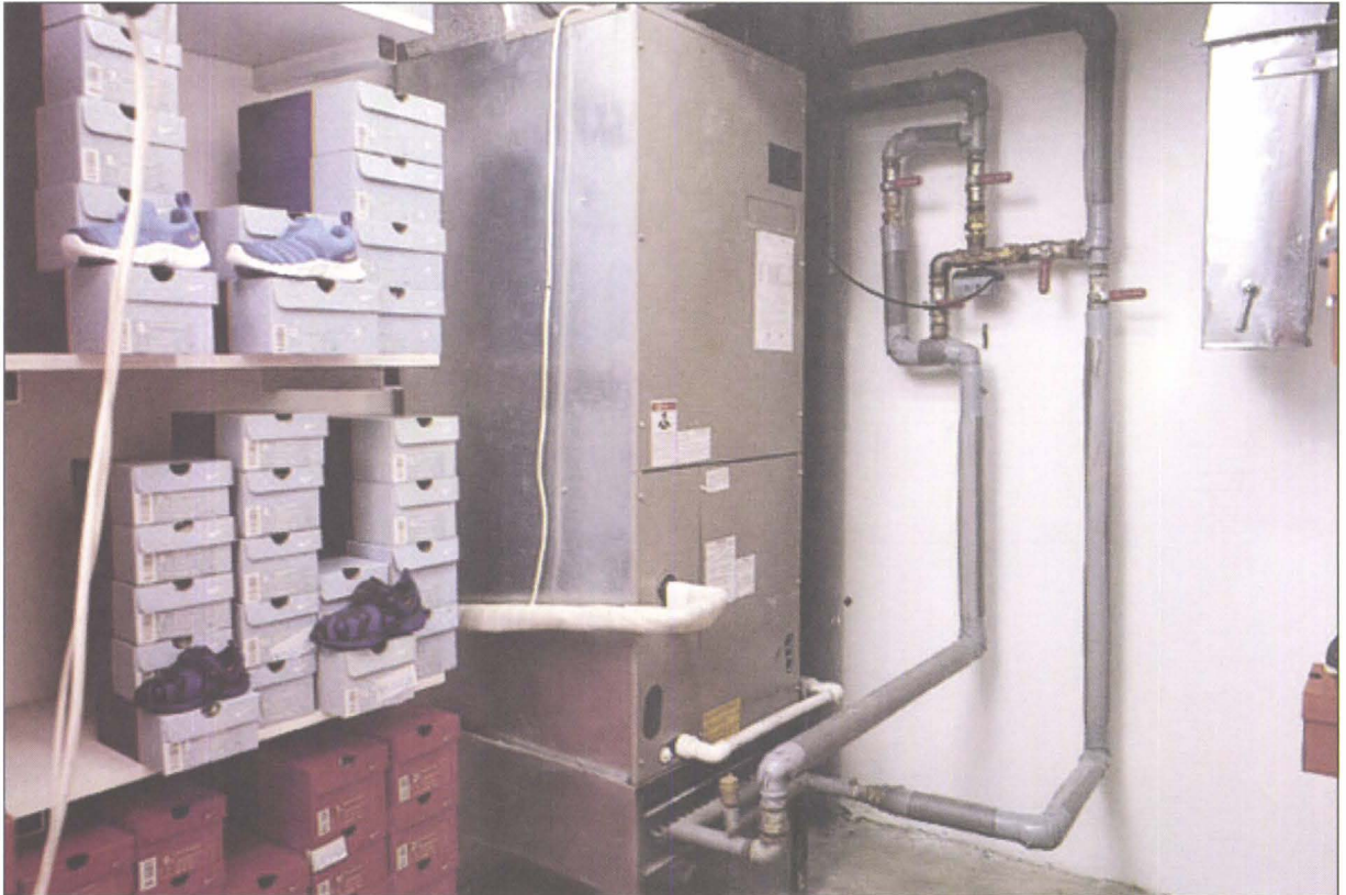
Şekil 4.21. MAĞAZA UYGULAMA ÖRNEĞİ KANAL TİPİ KLİMA DEPODA
