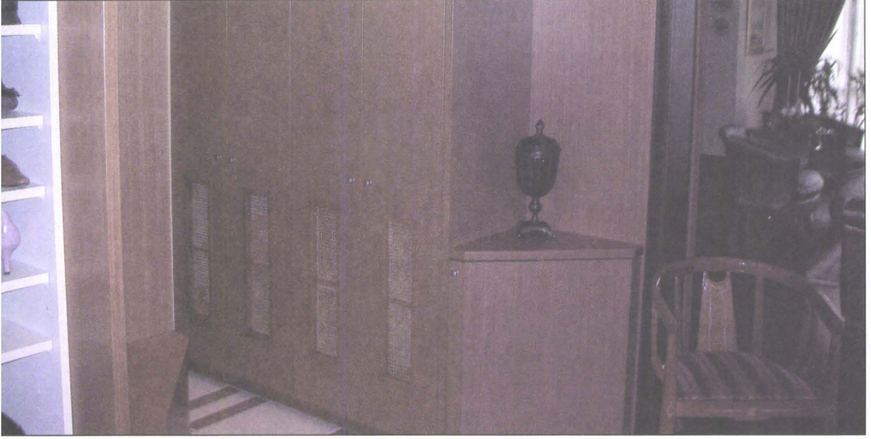
Şekil 5.34. Trio Konutları HAVA KANALLI SPLİT KLİMA İÇ ÜNİTE YERLEŞİMİ (DOLABIN DIŞTAN GÖRÜNÜŞÜ)
