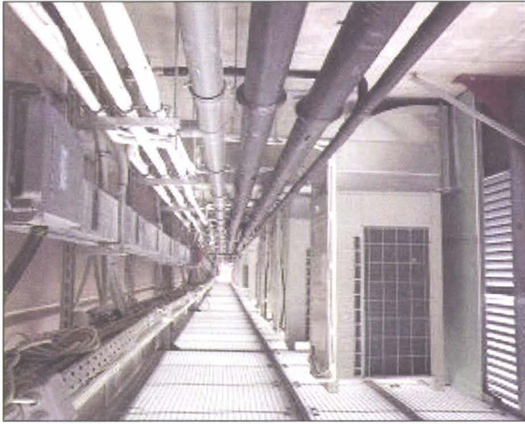
Şekil 5.89. TESİSAT GALERİSİNDEKİ DIŞ ÜNİTE UYGULAMA ÖRNEĞİ
